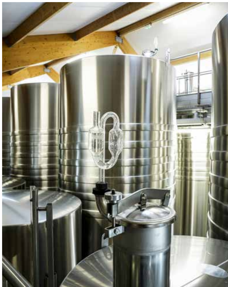
Vatenruimte. Salle de cuves.
